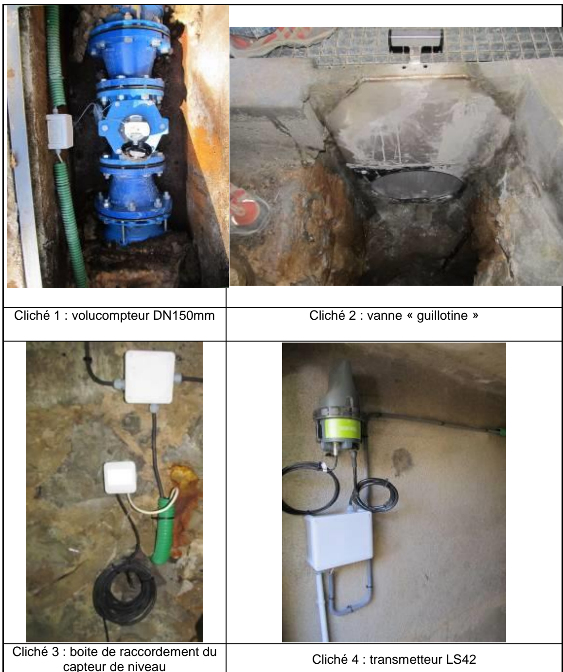
Fig. 39. PHOTOS DE L'INSTRUMENTATION DU CAPTAGE DE VERDUS
