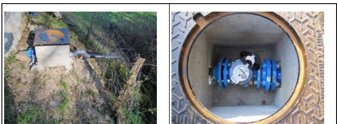
Fig. 47. CLICHE 14 : COMPTEUR EQUIPANT LE TROP PLEIN
