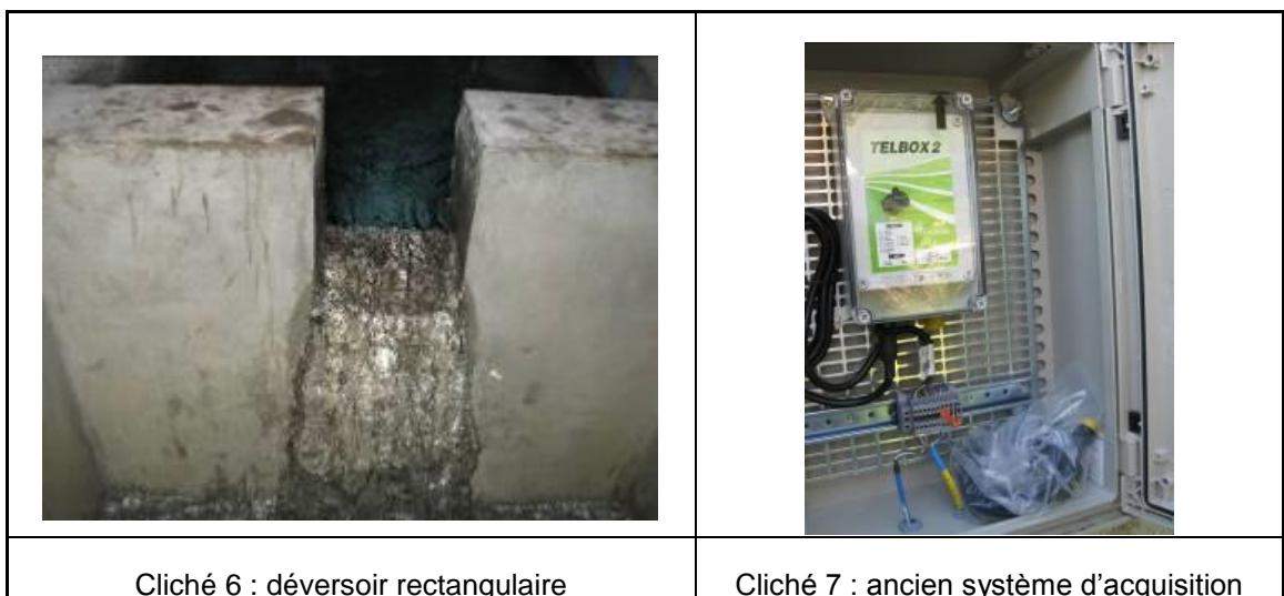
Fig. 42. PHOTOS DES EQUIPEMENTS DU CAPTAGE DU BOUCHET
