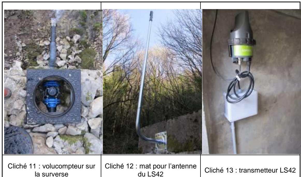
Fig. 46. PHOTOS DE L'INSTRUMENTATION DU CAPTAGE DU CHEMIN DES DAMES
