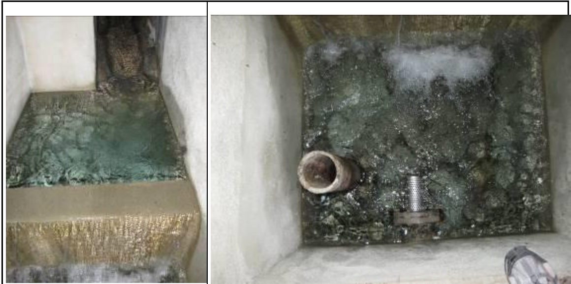
Fig. 41. CLICHE 5 - VUE SUR LE DECANTEUR DU CAPTAGE DE RIPPERT
