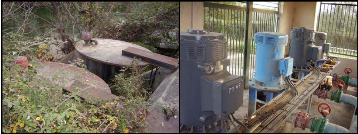
Photo 1 : Pompage dans la Cèze, et surpresseur réseau de l'ASA de Saint-Jean-de-Maruéjols
