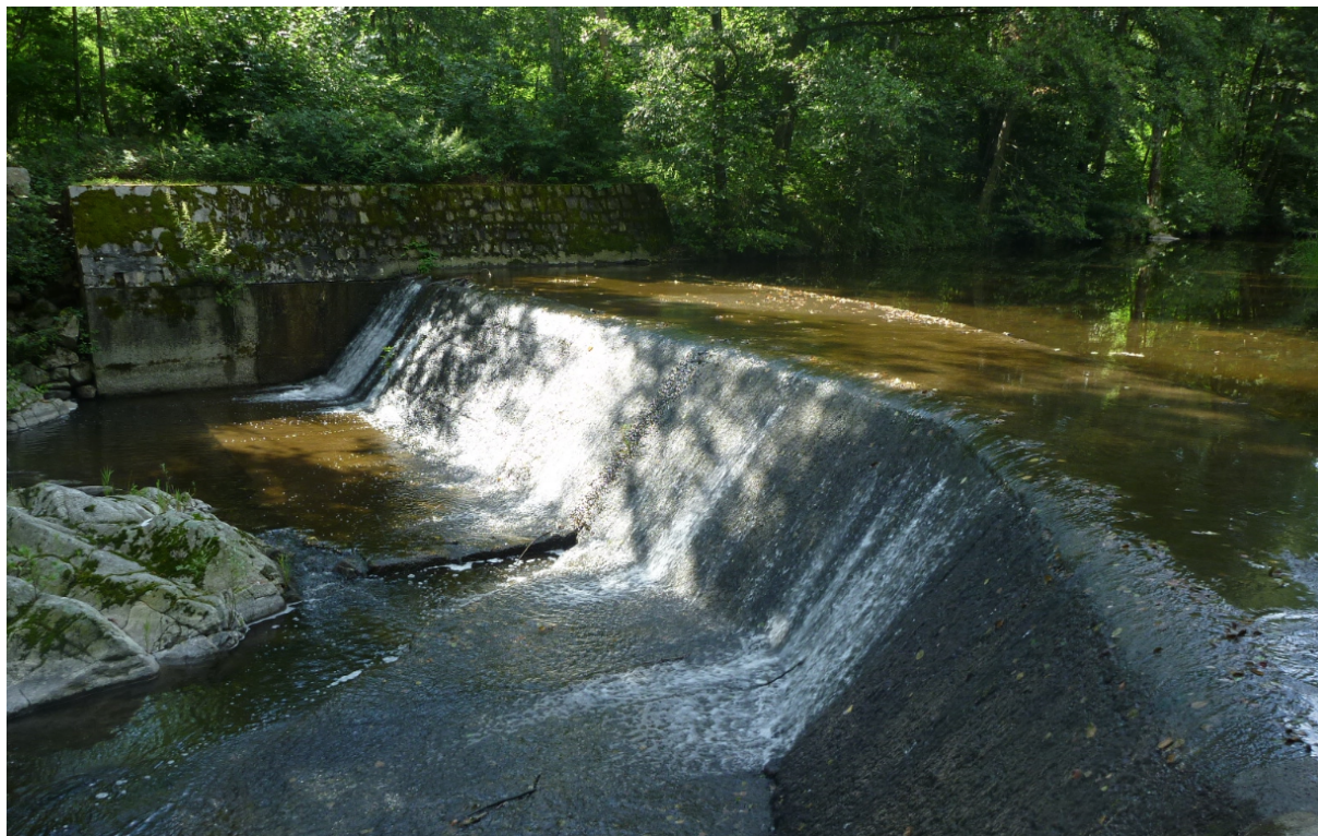
Photo 4 : Seuil prise d'eau de Munas : au pied du seuil, au centre, une rigole a priori maçonnée
