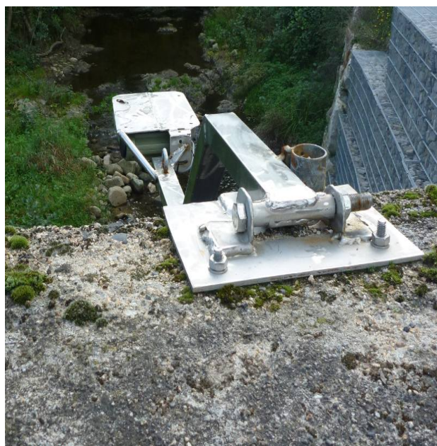
Capteur vissé sur le pont
