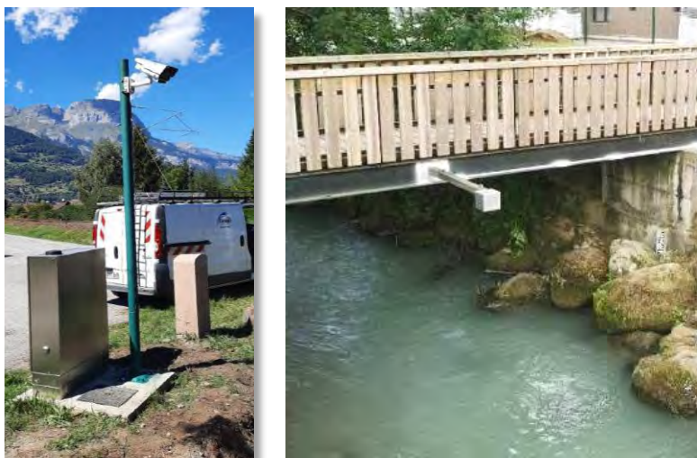
Exemple de station installée sur la Bialle à Sallanches
